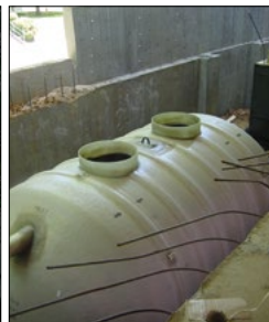
6. Cisterna per la raccolta dell'acqua
